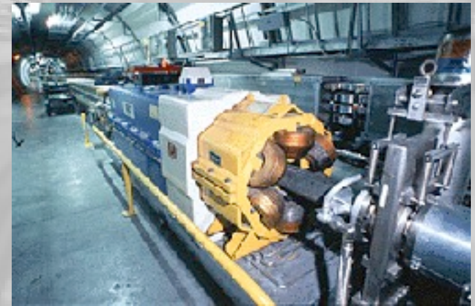
Tunnel, Strahlröhre, Vakuumpumpen, Sextupol, ...
